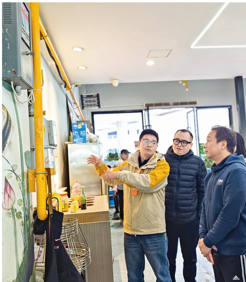
检查组对阀门和燃气安全装置进行检查。(叶深秋 摄)
