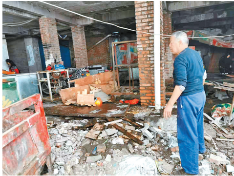
金川大院停车场整治前
