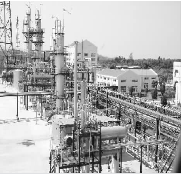
中石油西南油气田分公司重庆天然气净化总厂达州分厂自2008年4月28日在大竹县投入生产以来，已累计处理3.6亿方天然气，通过中石油输气管网，送往全国各地。图为厂区设备正在运转净化天然气。(谢静 摄)
